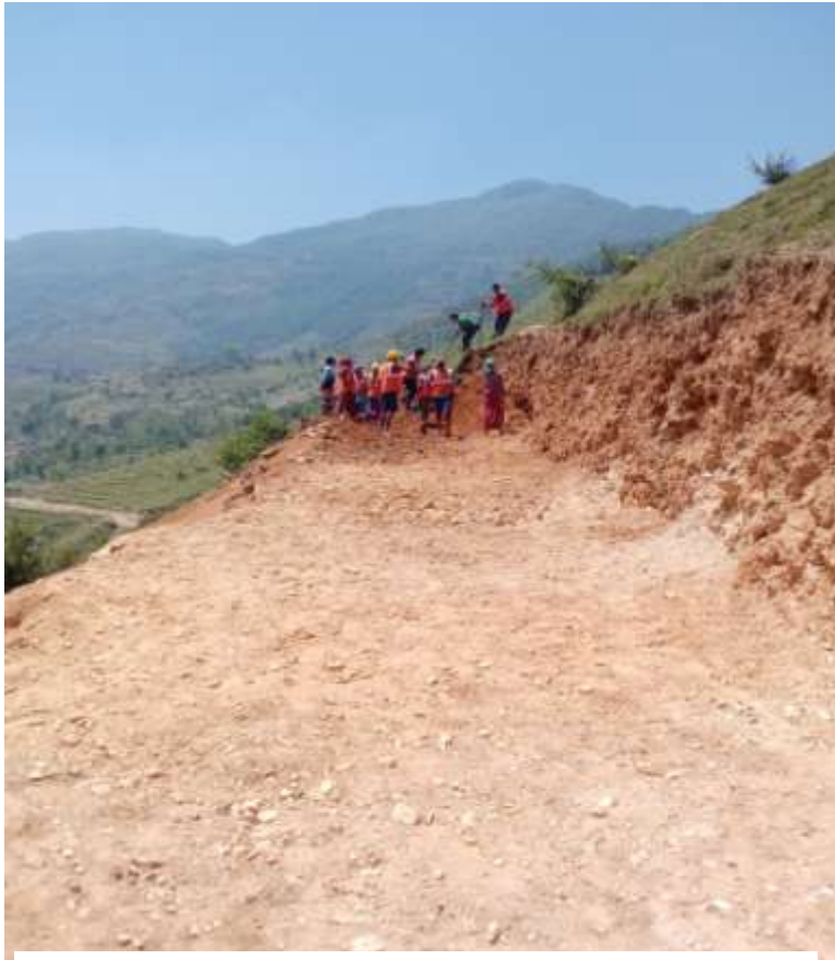
वडा नं. ७ कट्टी स्थित दाडीम देखि माईकाथान धारा कृषि सडक निर्माण कार्य हुँदै गरेको दृश्य ।
