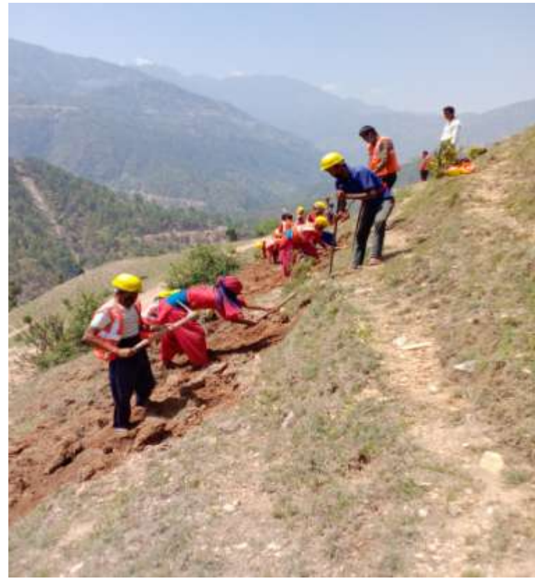
चित्र नं. ६ : वडा नं. ५ कट्टी स्थित दाडीम देखि माईकाथान धारा कृषि सडक निर्माण कार्य हुँदै गरेको दृश्य ।
