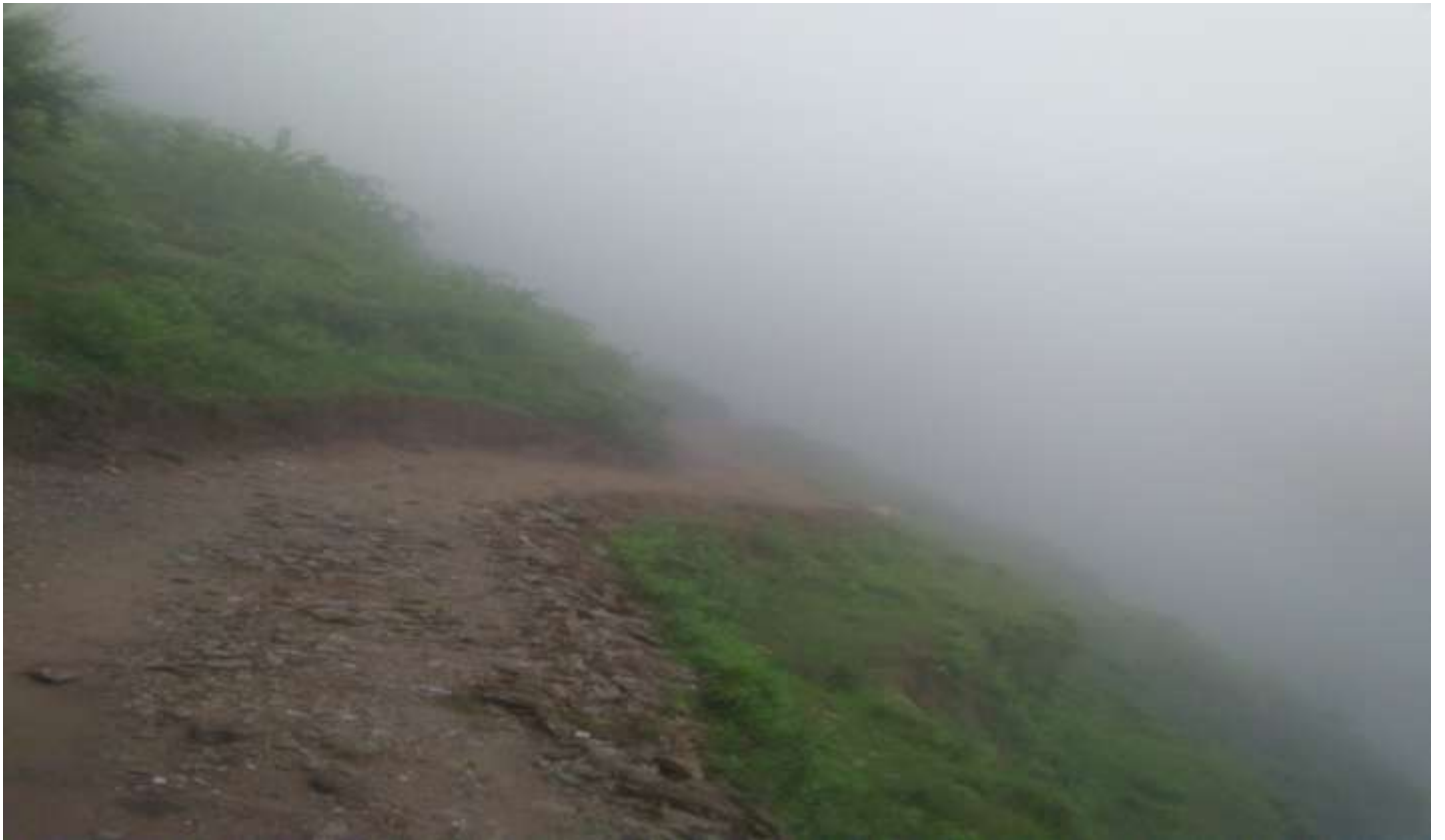
वडा नं. ३ मेहेलतोलि धारा देखि रुमी सडक निर्माण कार्य सम्पन्न पछिको दृश्य ।
